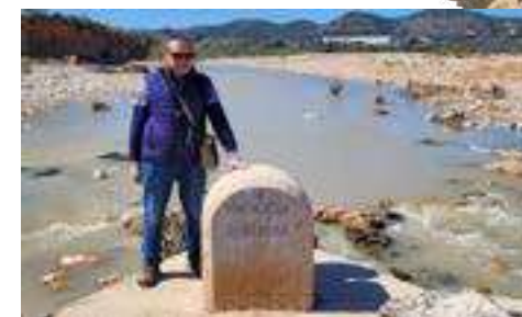
Badén tras el paso de la Dana.
