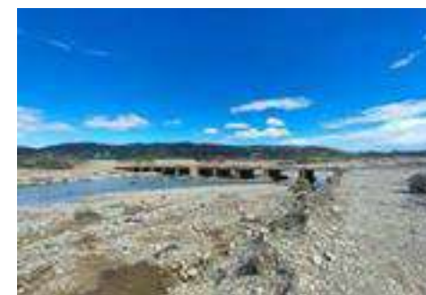
Misma foto con la bassa ya desaparecida.
